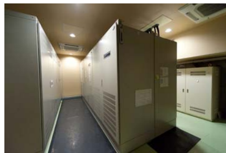
図 4. UPS 装置(200kVA x 3 台)
