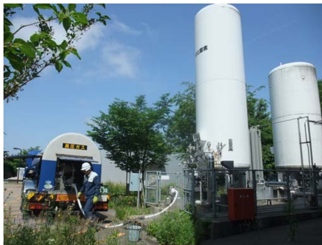
図 1. 本学液体窒素貯槽（ナノセンター脇）左にあるのは業者のタンクローリー（写真は購入している時のもの）、右側の 2 本の貯槽のうち、左側がガス取り用、右側が液取り用となっている。
