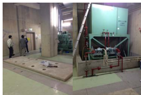
図5. 電気室の様子
