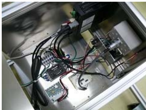
図 2. ターンテーブル制御盤内部
