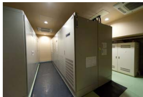
図4. UPS装置(200kVA x 3台)
