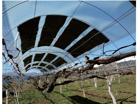
図4 小型分散電源 農園への設置例 *9
