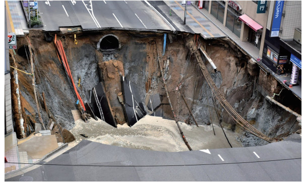
図8 博多駅前陥没（2016年11月）
