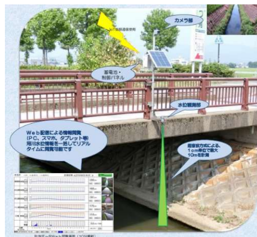
図 10 河川水位計システム
