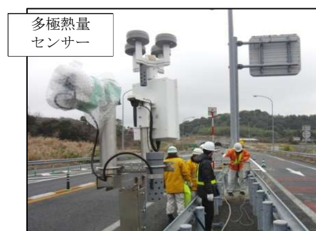
図7 多極熱量センサー設置状況
