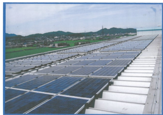
図 2 コナン市民共同発電所) 2号機 105.6 kW
