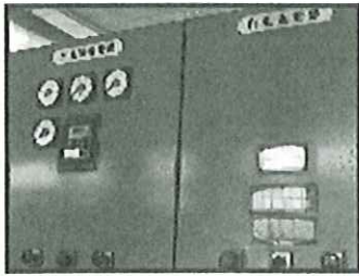
ポンプの電気を調節する配電盤
