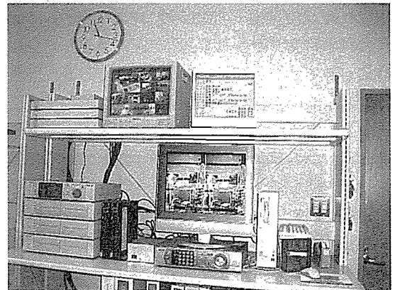
写真3 監視モニター (上段左・下段) と図書館ゲートモニター (上段右)
