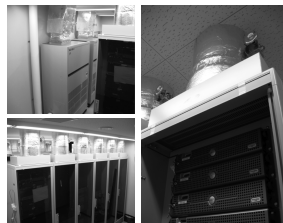
エアコン冷気を直接ラック内へ
